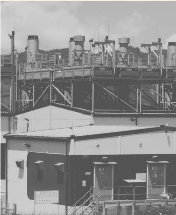
Planta de generación Termo Mechero Morro - Yopal
