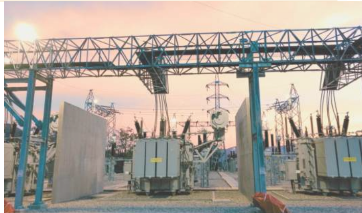
Subestación Termo Mechero Morro - Yopal
